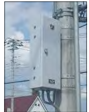
【信号機電源付加装置の整備】
