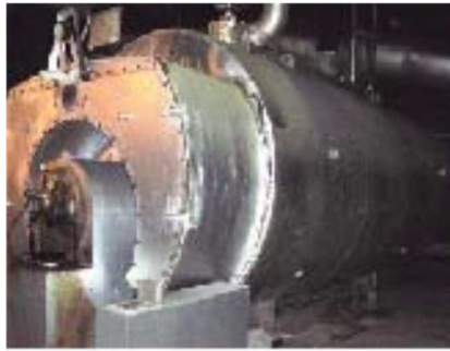
ボイラー保温材
