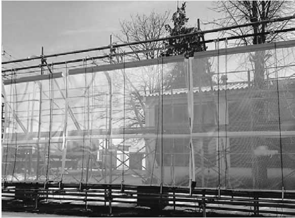
試験中のネット脱臭装置
