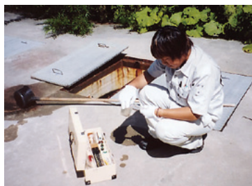
△ 浄化槽の管理作業
