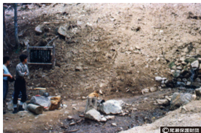
▲工事が中止になった道路（岩清水付近）
