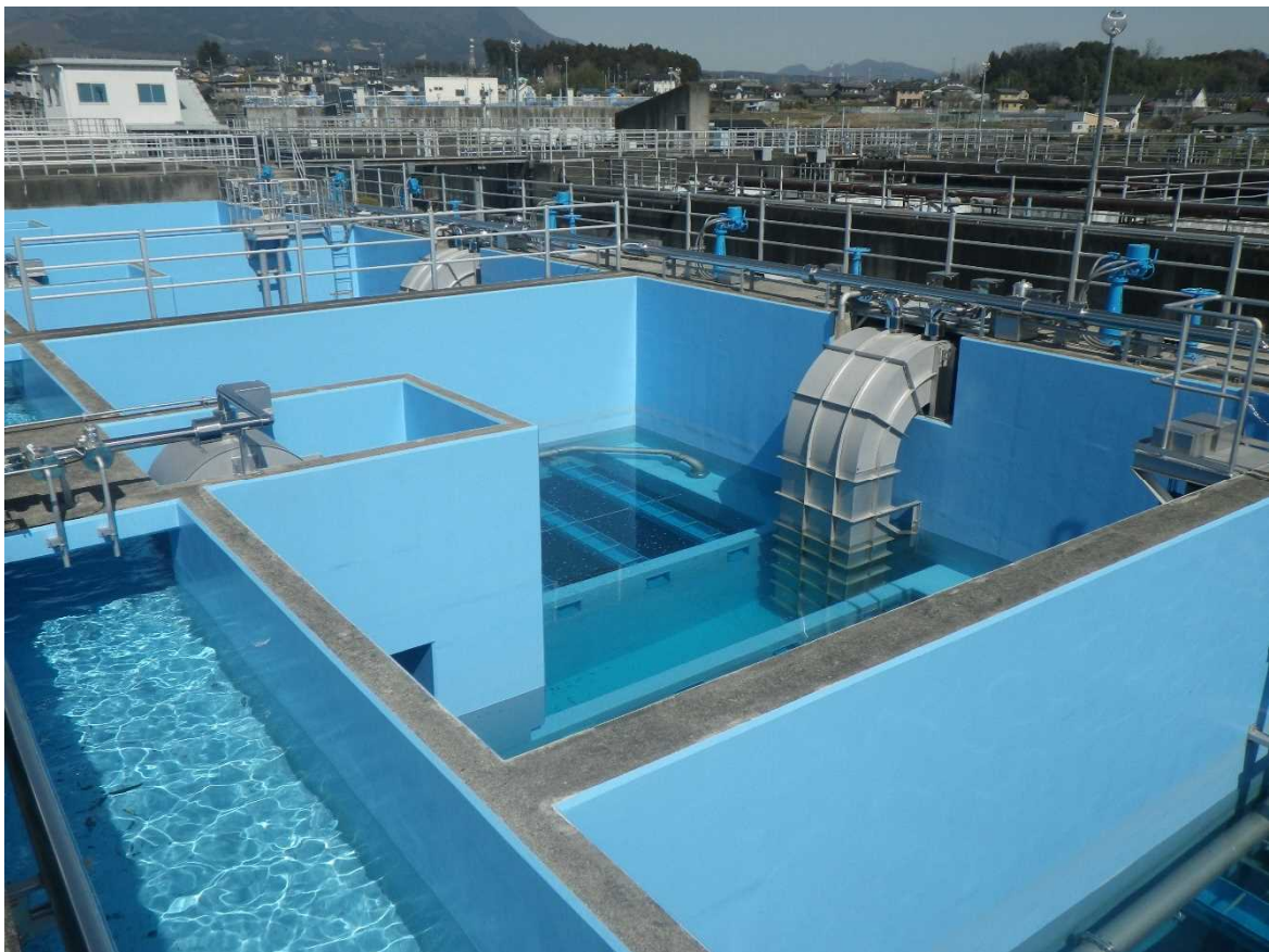
県央第一水道事務所 2系ろ過池
