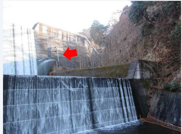
⑤ 未使用取水管
