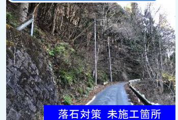
落石対策 未施工箇所
