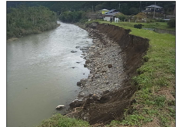
桐生川の河川施設の被災状況
