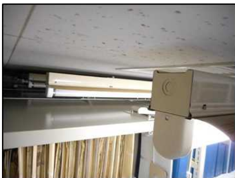
(写真2) 新館書庫 天井との隙間
