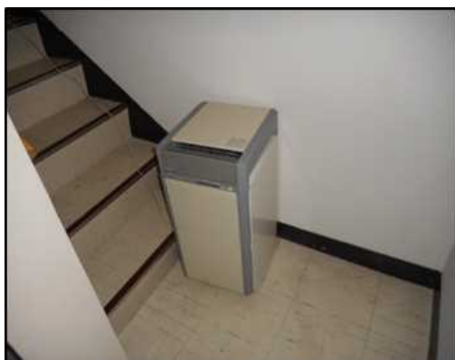
(写真6) 本館 書庫連絡階段除湿器
