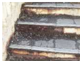
蹴上げの腐食
