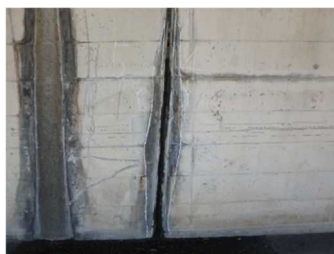
遊離石灰の発生
