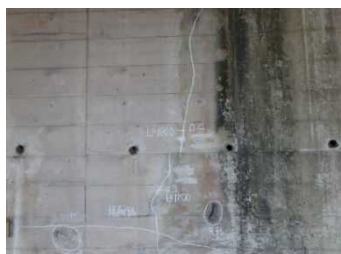
ひび割れの発生
