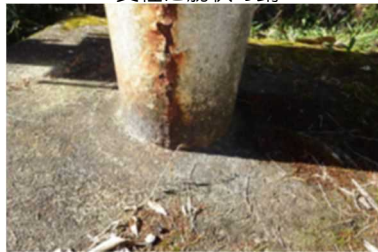
支柱に筋状の錆
