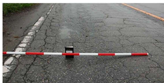
図-2.3 損傷事例（ひび割れの進行した路面）
