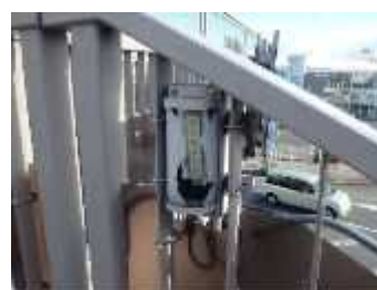
照明の変形・欠損
