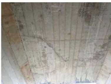
写真① コンクリートひび割れ
