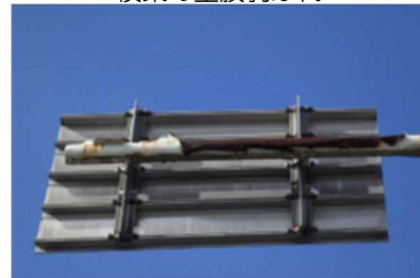
横梁の塗膜剥がれ
