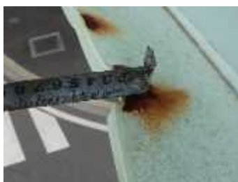
主桁の変形・欠損
