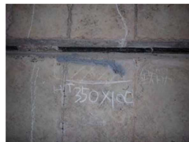
写真③ 鉄筋露出
