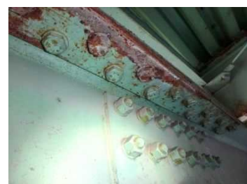
ボルトの腐食
