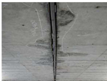
写真② 目地の漏水
