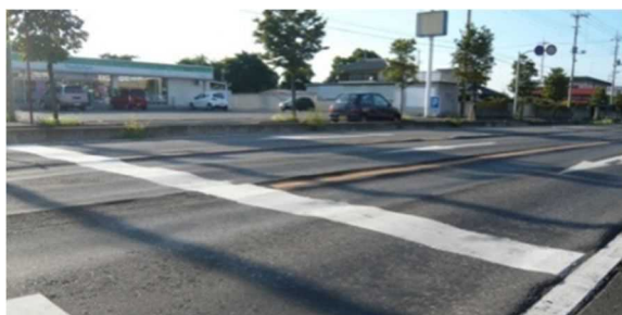
図-2.2 損傷事例（わだち掘れの進行した路面）
