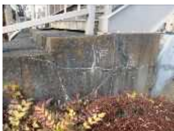
橋台のひびわれ
