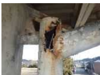
排水管の腐食
