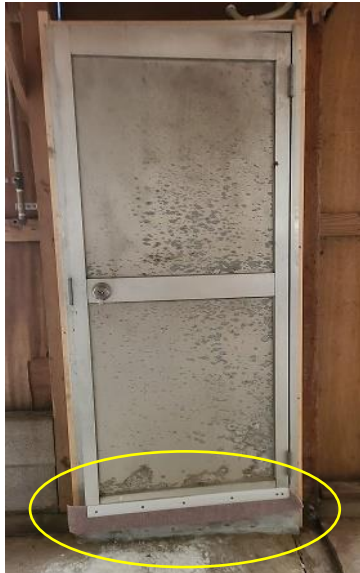
豚舎入口ドア下の隙間をマット (黄色の丸部分)で塞いだ例。
