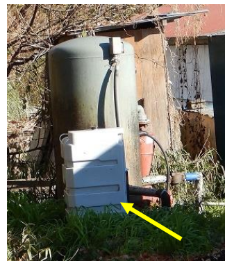
井戸水の配管に消毒のための塩素投入装置（矢印）を設置した例。
