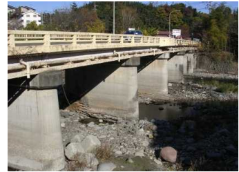
河床低下により橋脚基礎部が露出
