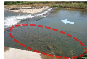
流出土砂が帯工上流部に堆積
