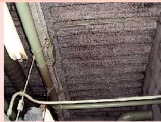
吹付け石綿 (レベル1)
