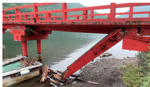
写真2：神社側の橋桁落下状況
