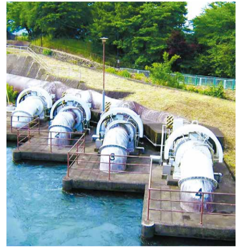
小水力発電(天狗岩発電所) 農業用水を利用して、年間約180万kWhの電力を供給しています。一般家庭約500軒分の年間消費電力に当たります。
