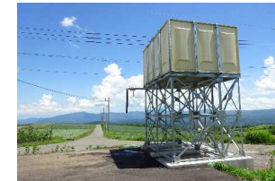
新設した受水槽 (干俣地区)
