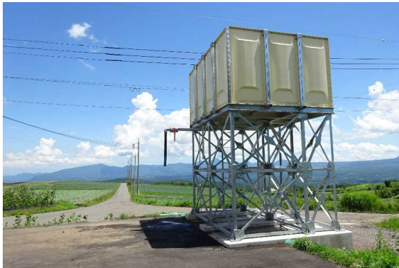
新設した受水槽 (干俣地区)
