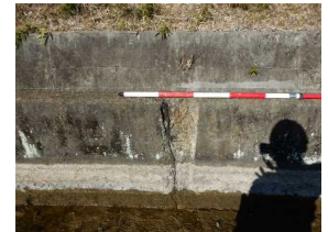
神流川用水地区水路の鉄筋露出状況
